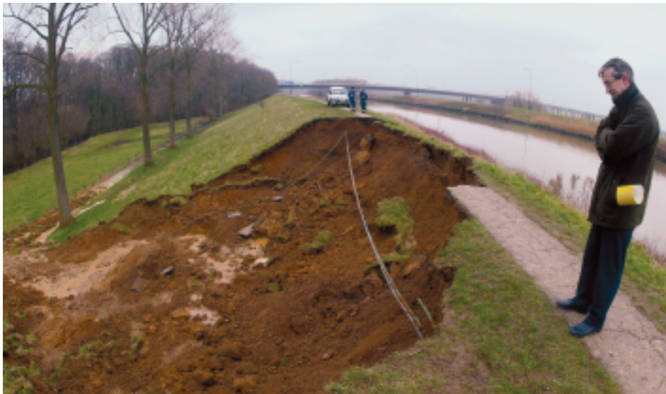
De bezwijking van de dijk van het Julianakanaal bij Stein in 2004.
