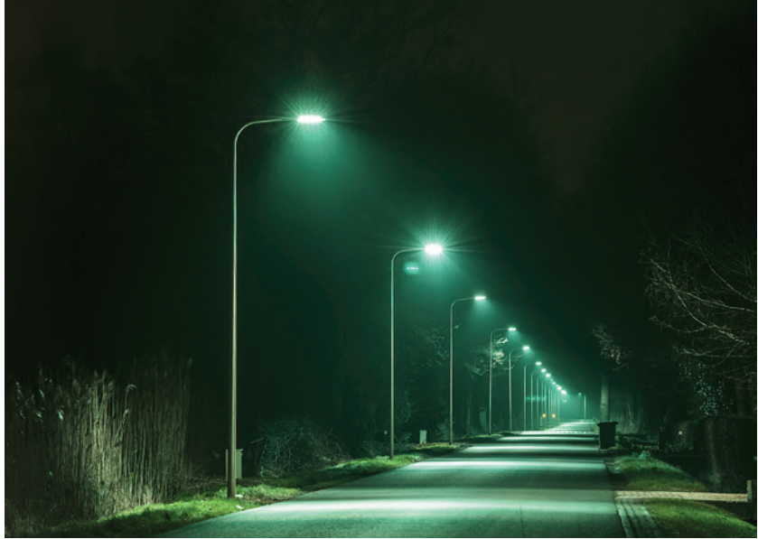
LED street lights in Beckumerstraat in Boekelo, municipality of Enschede
