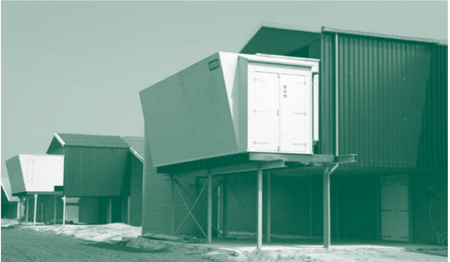
Twee luchtwassers bij varkensstallen (foto: UniqFill Air).
